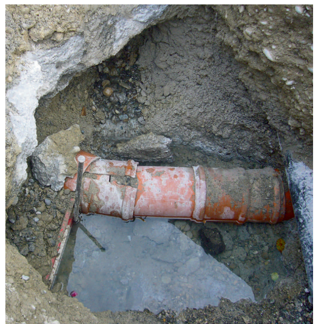
Fig. 1 Nicht fachgerechte Abwasserleitung mit Wasseraustritt
