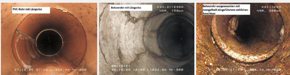
Fig. 3 Die Rohrinspektion mittels Kanalfernsehen bringt eine Vielzahl von wassergefährdenden Infrastrukturschäden zum Vorschein. (Bild oben: D. Wörner, AWA Bern; unten: Ing.-Büro Hans Ulrich Gränicher)
