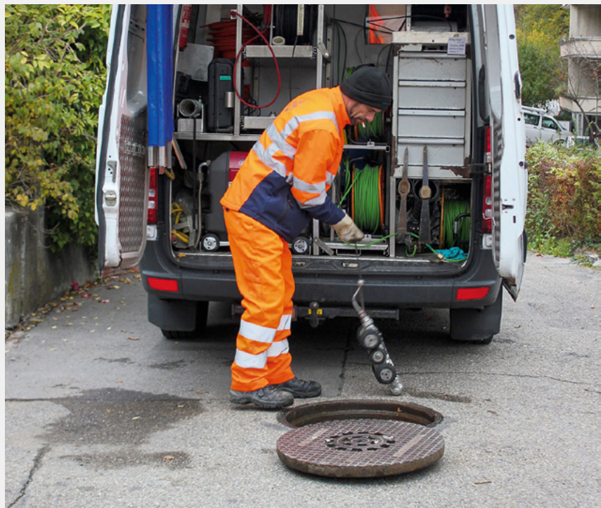
Fig. 2 Vorbereitungsarbeiten für die Untersuchung eines privaten Hausanschlusses mittels Rohrinspektion durch eine fahrbare Kanal-TV-Kamera. (Bild: D. Wörner, AWA)
